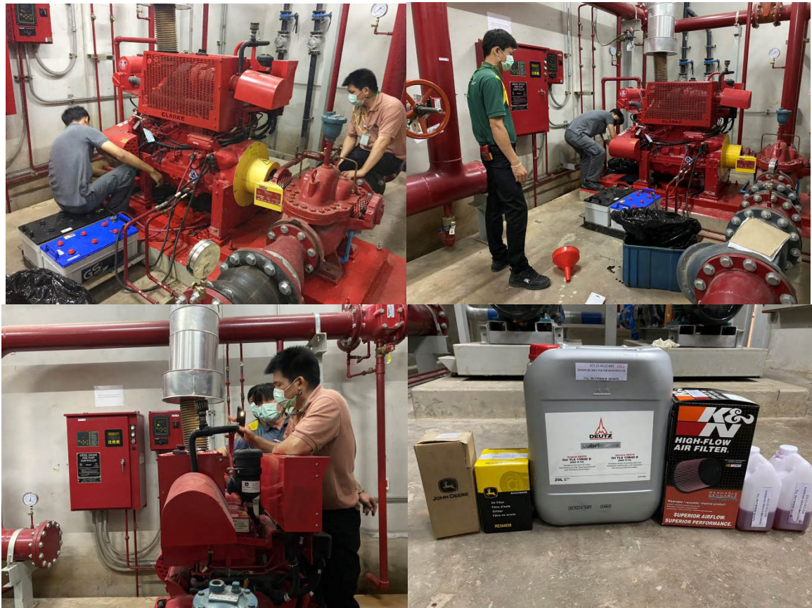
ภาพการบำรุงรักษาเชิงป้องกันเครื่องสูบน้ำดับเพลิง (Fire pump)
