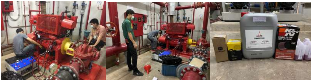
ภาพการบำรุงรักษาเชิงป้องกันเครื่องสูบน้ำดับเพลิง (Fire pump)
