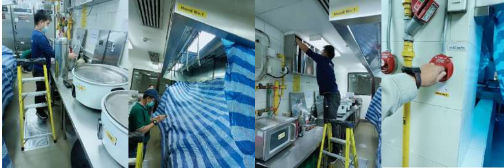
(ภาพการตรวจสอบระบบดับเพลิงภายในห้องครัว) (Ansul system)
